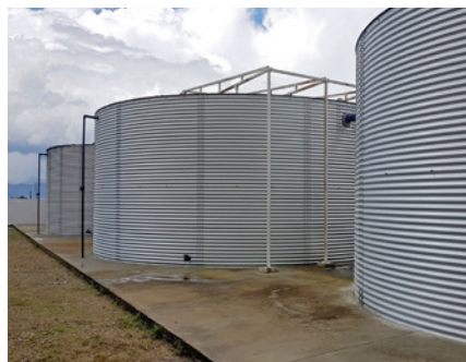
Planta de Tratamiento de Aguas, Del Toro
